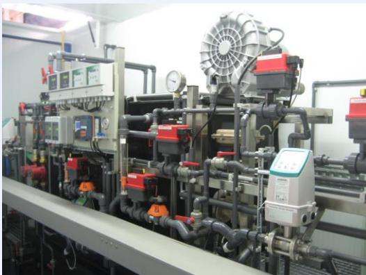
Planta pilot de bioreactor de membrana (MBR)
